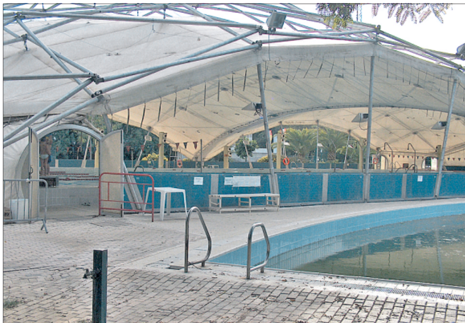
La cubierta de la piscina de 50 metros está ya «caducada», según les ha dicho a los padres la dirección. M. F.
